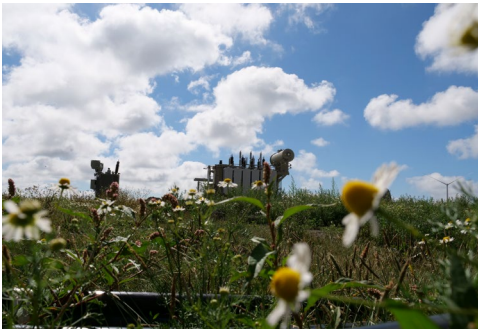
Transformeren i Høvsøre
