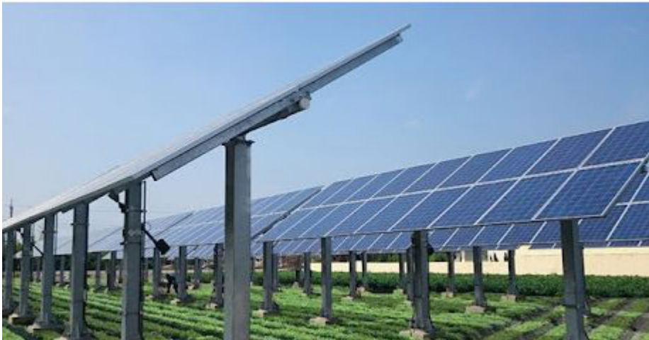
Eksempel på solcellepaneler på tracking system.
